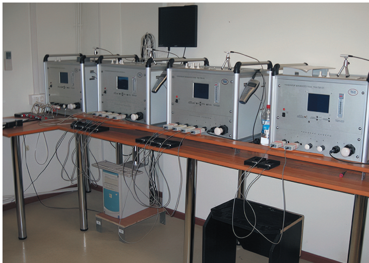
РИС. 1. ► Калибровочный центр, оборудованный группой генераторов ТКА-ГВЛ-01
